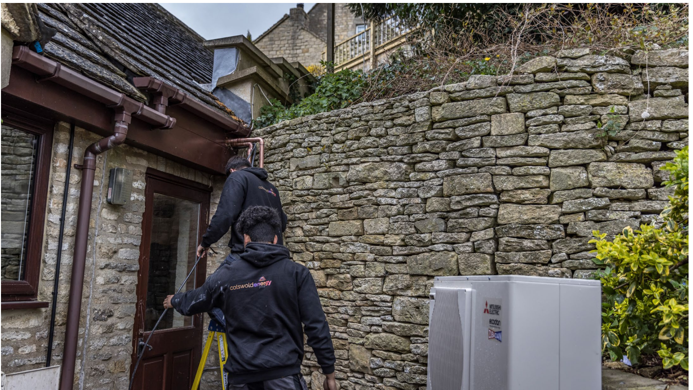
공기열 히트펌프 설치 모습. 자료: Cotswold Energy Group.
