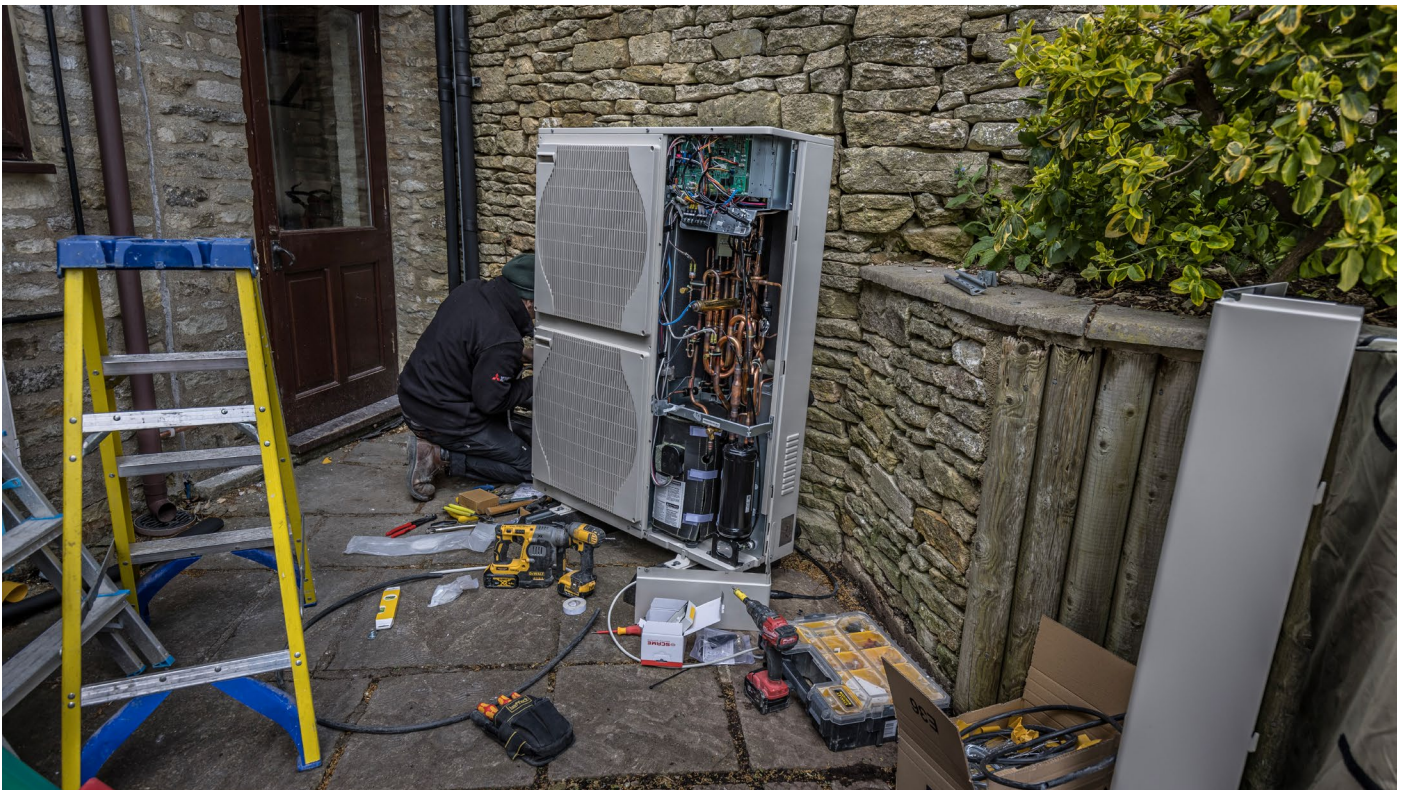
공기열 히트펌프 설치 모습. 자료: Cotswold Energy Group
