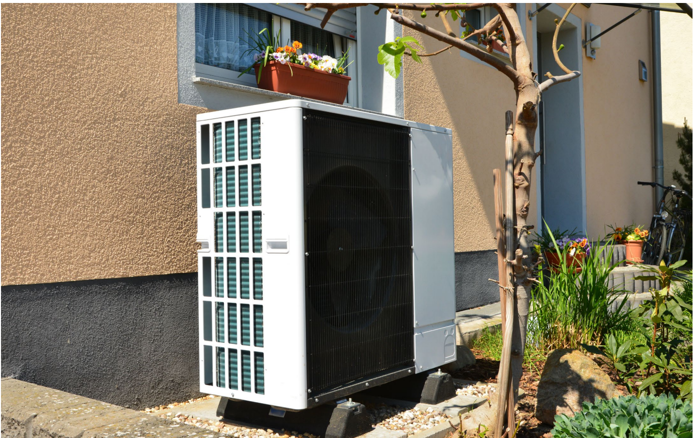
주택 외부에 설치된 공기열 히트펌프. 자료: CLASP.
