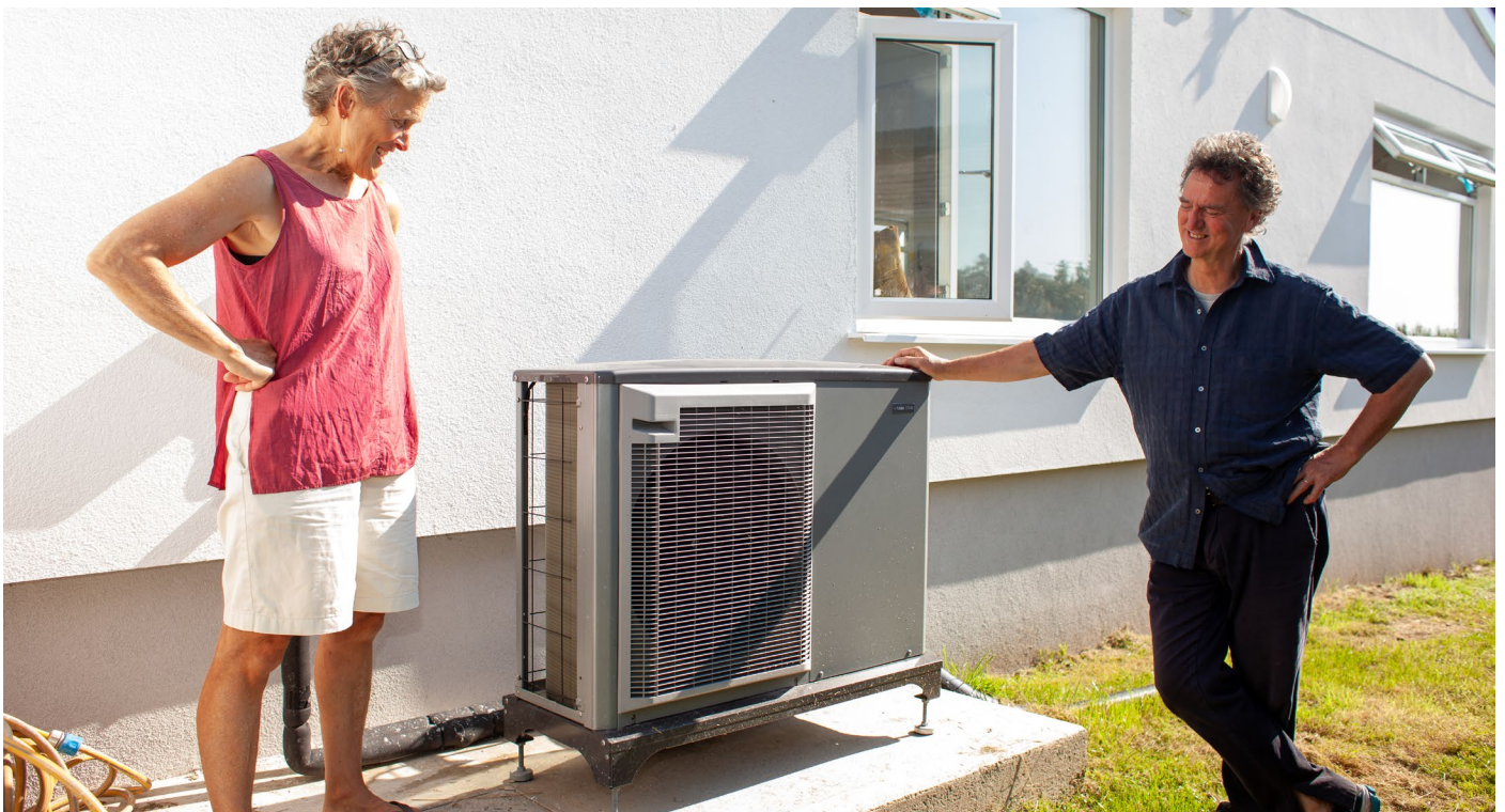
가정용 공기열 히트펌프. 자료: Jonathan Atkinson(@lowwintersun).
