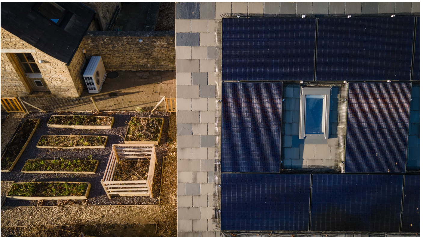
히트펌프와 태양광 패널이 설치된 건물. 자료: Cotswold Energy Group.
